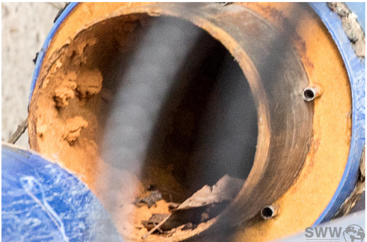
Bild 6: Anderes Rohr ebenfalls innen mit dicker Rost-Schicht und großen Rostpusteln Aufnahme: Alexander Schäfer, 12.7.2023
