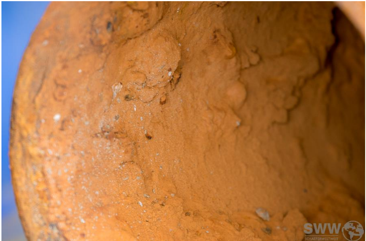
Bild 5: Eines der Rohre / Inneres mit dicker Rost-Schicht und vielen großen Rostpusteln Aufnahme: Alexander Schäfer, 12.7.2023
