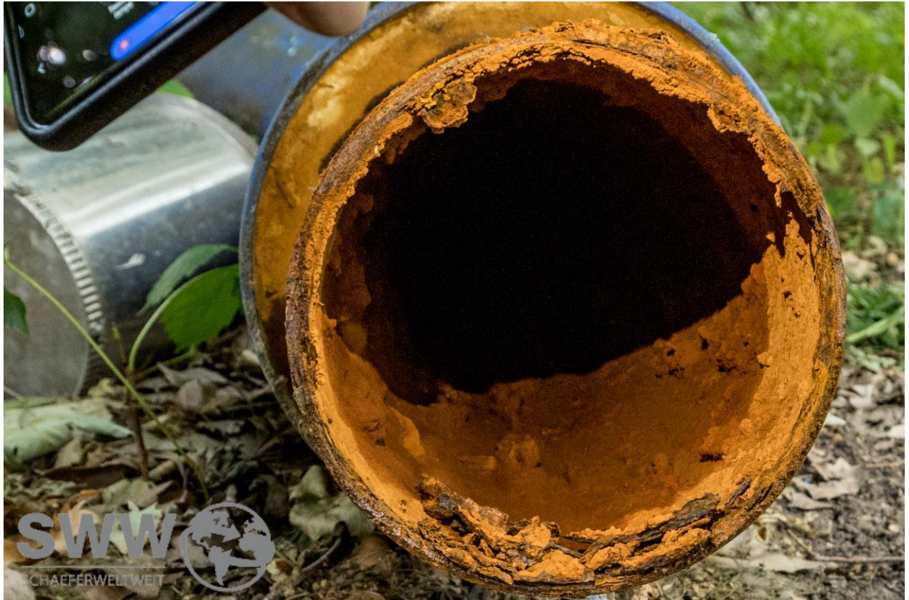
Bild 3: Nahaufnahme Rohr DN 200 mit zentimeterdicker innerer Rostschicht Aufnahme: Alexander Schäfer, 12.7.2023
