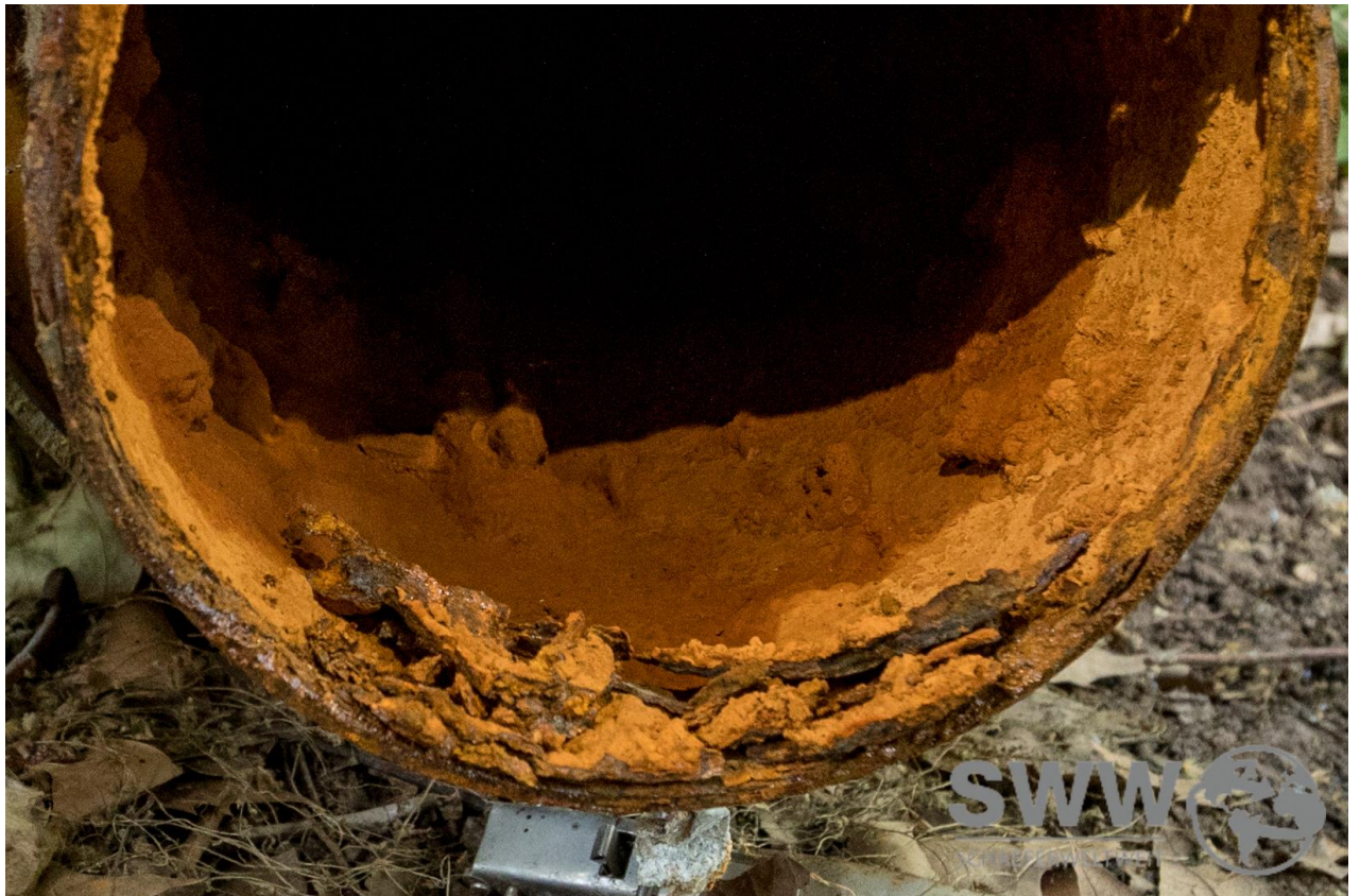
Bild 4: Nahaufnahme: Die Rohrwand ist weitgehend durch Rostbildung aufgezehrt Aufnahme: Alexander Schäfer, 12.7.2023.
