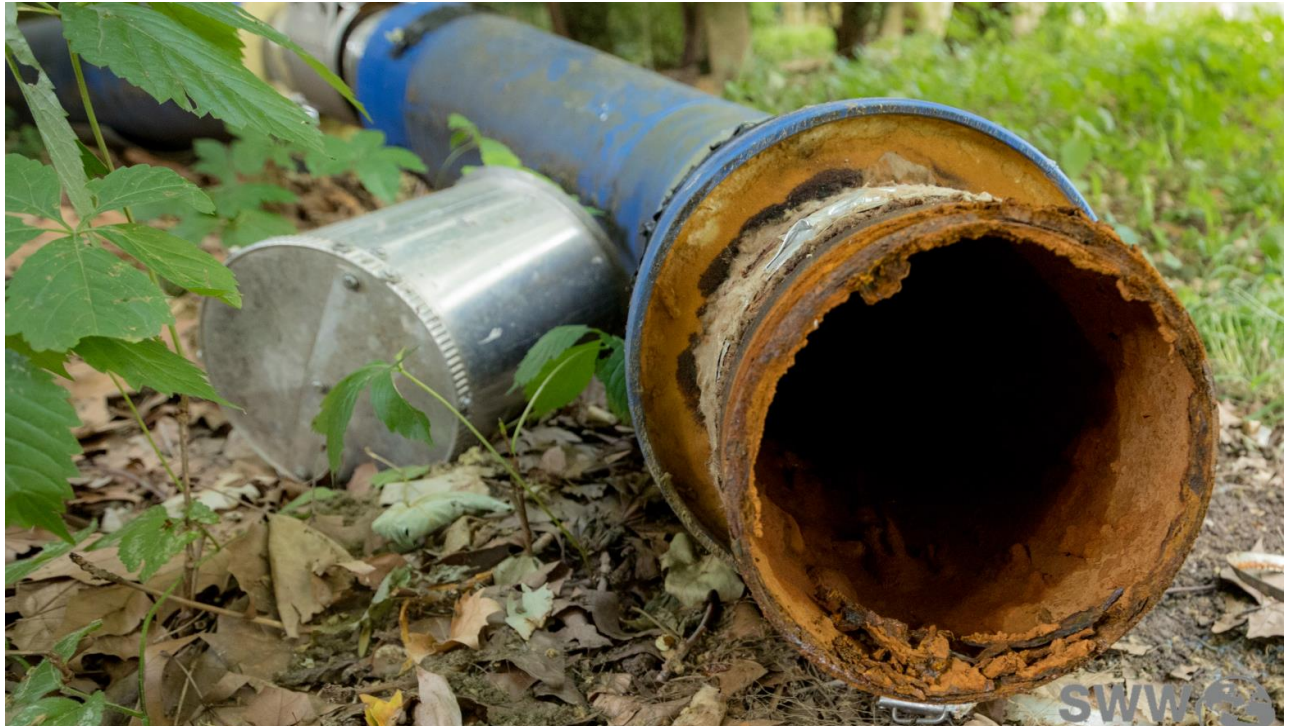
Bild 1: Überschussleitung DN 200, innen stark verrostet Aufnahme: Alexander Schäfer, 12.7.2023
